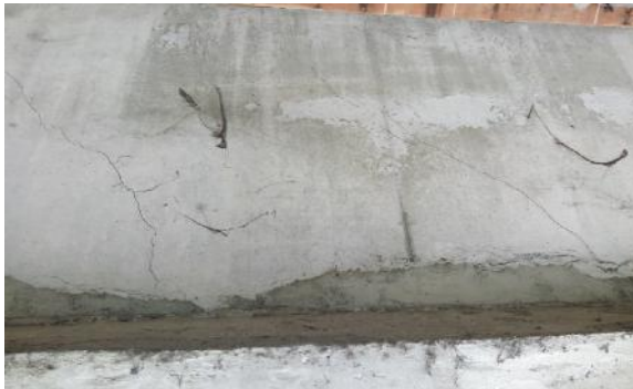
Gambar 4. Pola Keretakan pada Balok Struktur yang Mengarah pada Keretakan Geser
